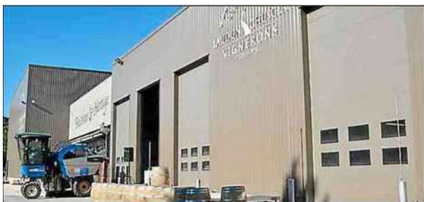
■ Le chai de blanc a été entièrement refait. Les travaux débutés en mars dernier ont été réalisés en six mois.
